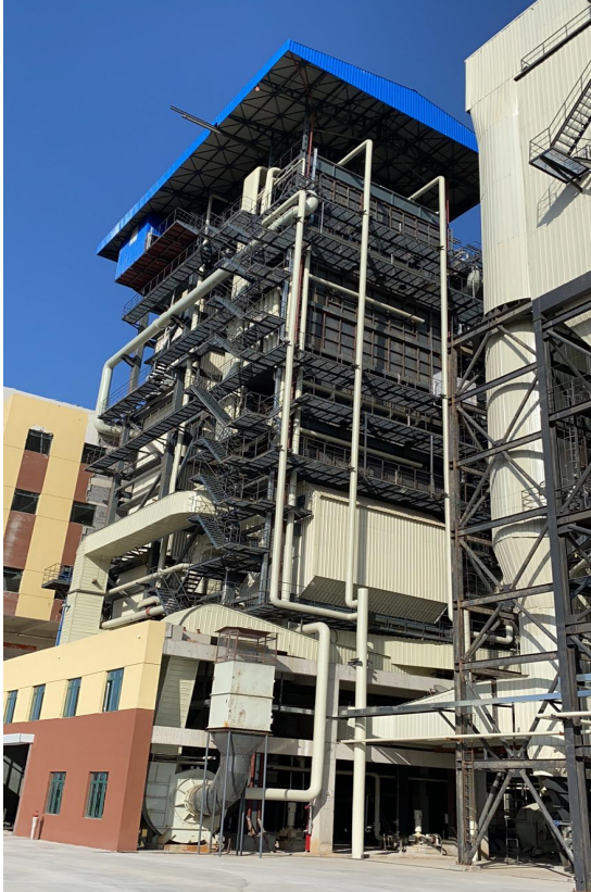
项目 6#116MW 兰炭热水锅炉
