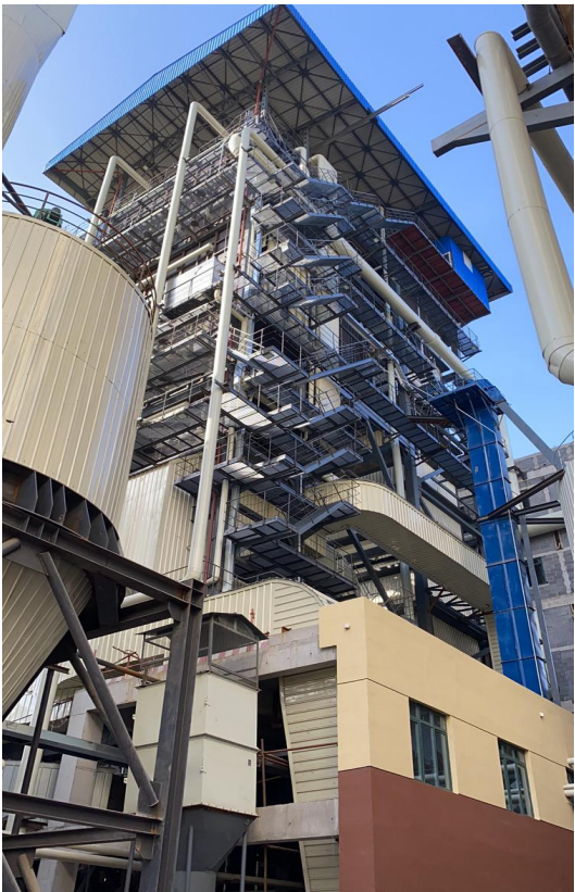
项目 5#116MW 兰炭热水锅炉
