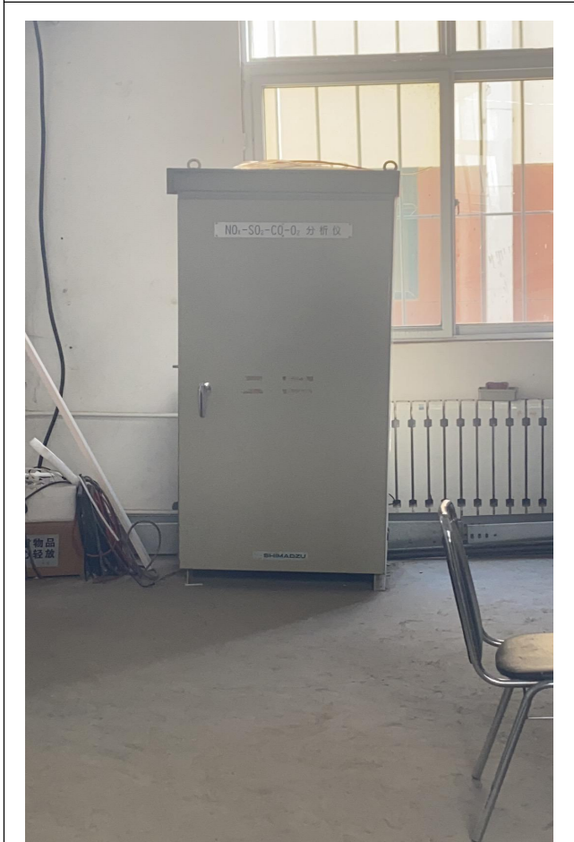
项目废气在线监测设备
