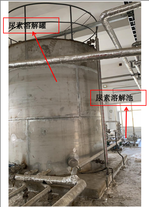
项目尿素溶解池、溶解罐
